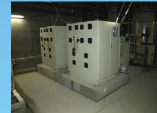
オゾン発生装置
